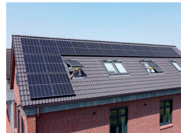
Bernd Lüders und Henning Zimmermann führen die Endabnahme der neuen Photovoltaik-Anlage durch.
